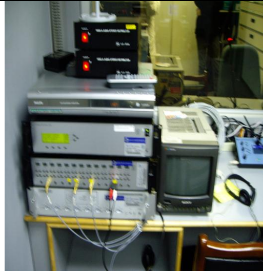
●中央控制室，桌面近照圖之一。
